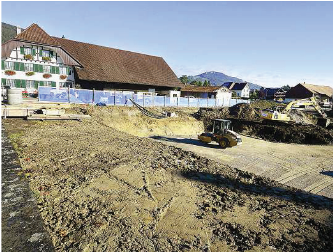
Eine grosse Baustelle präsentiert sich aktuell an der Dorfstrasse in Niederbipp. Hier werden jetzt zwei neue Mehrfamilienhäuser gebaut. Thomas Peter
